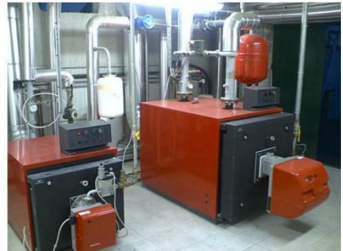
generatore di calore
